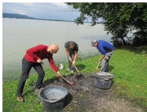
Beseitigung von Feuerstellen
